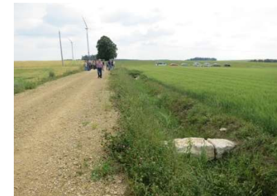
Reduzierung der Abflussgeschwindigkeit durch Großsteine in Wegseitengräben
