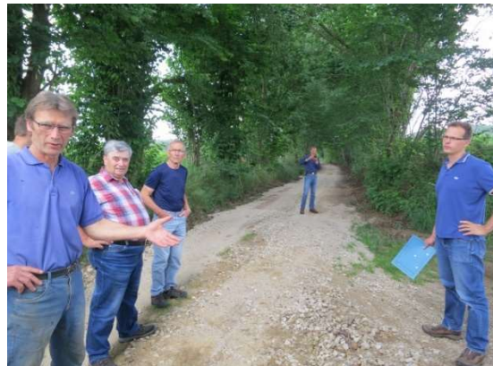
Wegebautyp 7a (Schotterweg) dessen Deckschicht durch Regenereignisse abgespült wurde. Abgelagerter Splitt muss aus den Mulden beseitigt und die Deckschicht erneuert werden.
